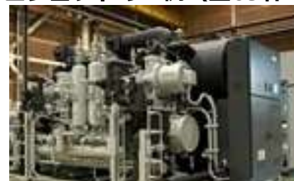
高効率冷凍機(インドネシア)
